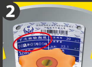
合格標示遭塗改、污損
