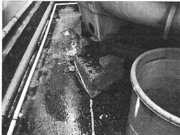
冷卻水塔漏水
