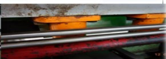
2-紅色警戒圓管(紅色柵隔離保護柵欄)及黃色前壓板
